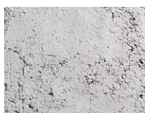
TX-019 2502 Rough Beton
